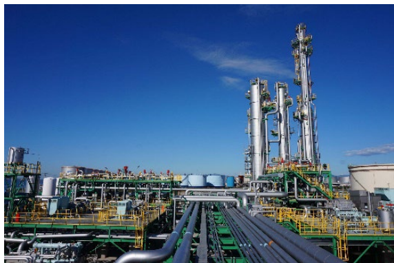
苫小牧CCS実証試験センター
