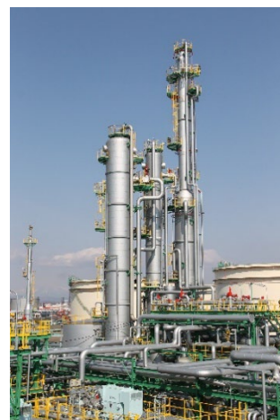
分離・回収設備
