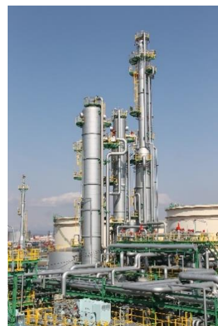
分離・回収設備
