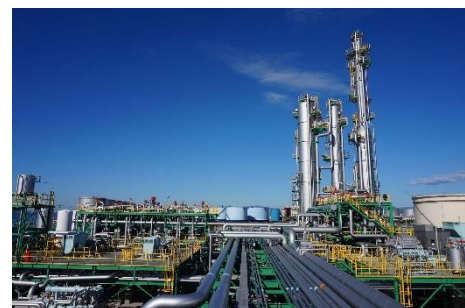
苫小牧CCS実証試験センター
