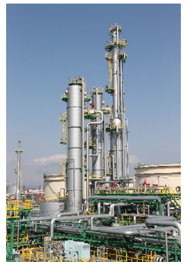
分離・回収設備
